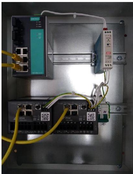
Рис. 4. Визуализация шкафа с установленными умными измерителями
